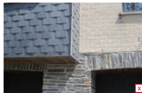
Juxtaposition d'un nombre trop important de matériaux différents.
