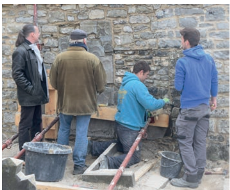
Restauration du mur de cimetière de Gerin (Onhaye) dans le cadre de l'appel à projet 16+ de l'Alliance Patrimoine Emploi.
